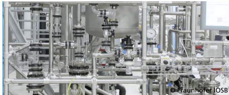
Monitoring von Komponenten in verfahrenstechnischen Anlagen – Fraunhofer IOSB
